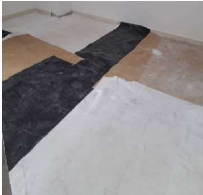
Figura 9: Forrado de enchape de piso
