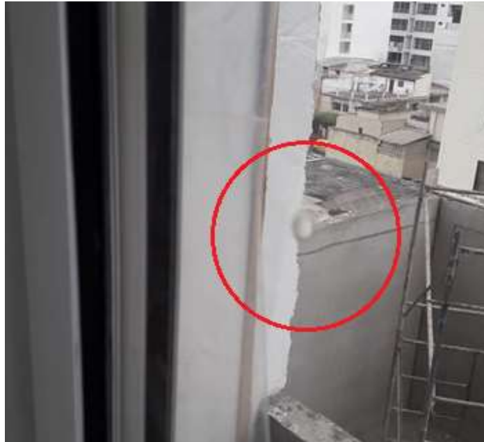
Figura 24: Vidrio de ventana con burbuja
