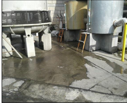
Figura 8. Evidencia del desbordamiento de agua en el tanque de almacenamiento, mantenimiento de llaves y tubería.
