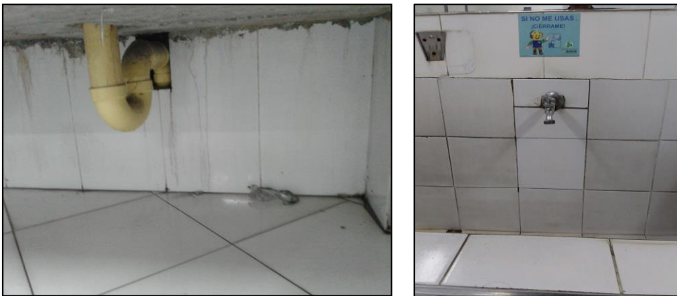
Figura 9. Evidencia de la fuga existente y arreglo de ésta en el baño de hombres ubicado en la planta de operaciones.
