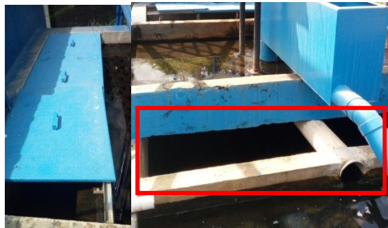
Imagen 12. Cámara de Recibo y Tanque de Retrolavado
