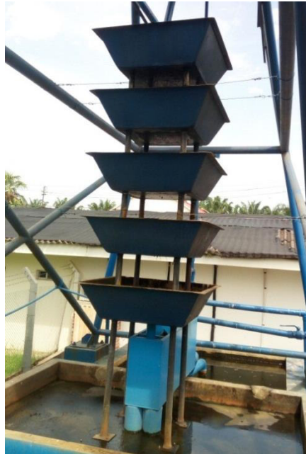
Imagen 3. Torre de Aireación
