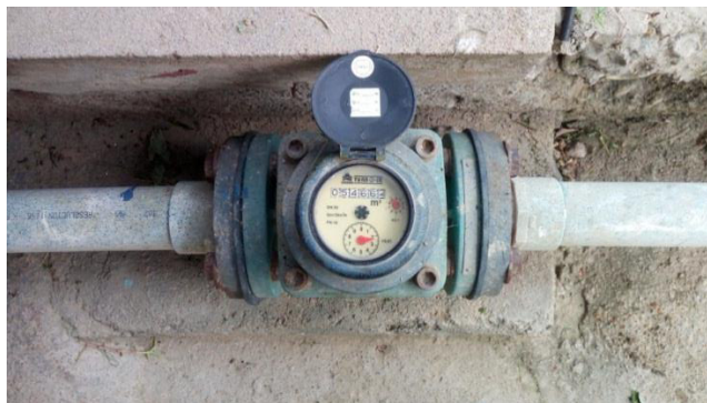
Imagen 3. Macromedidor para registro de caudal de captación
