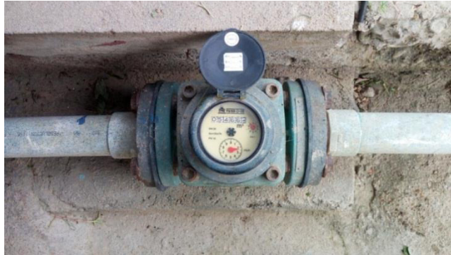
Imagen 2. Macromedidor para registro de caudal de captación
