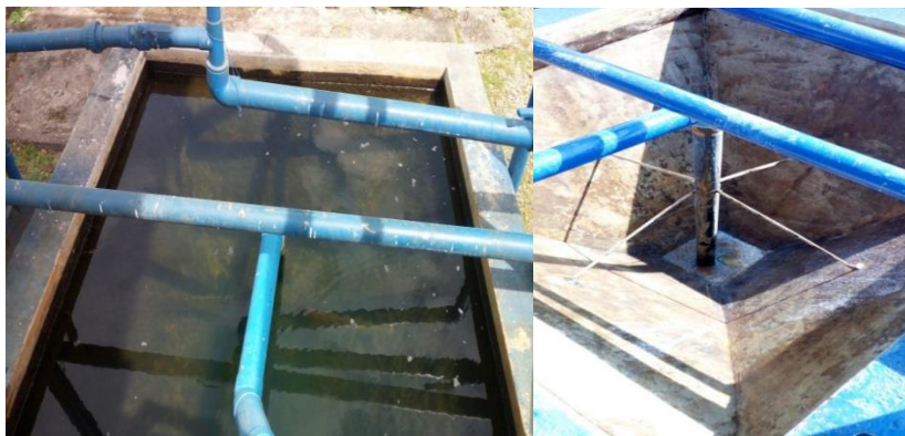
Imagen 9. Unidad de Floculación Hidráulica
