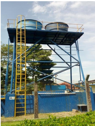
Imagen 12. Tanques de Reserva de agua tratada
