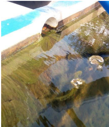
Imagen 10. Tubo de paso saturado de material orgánico
