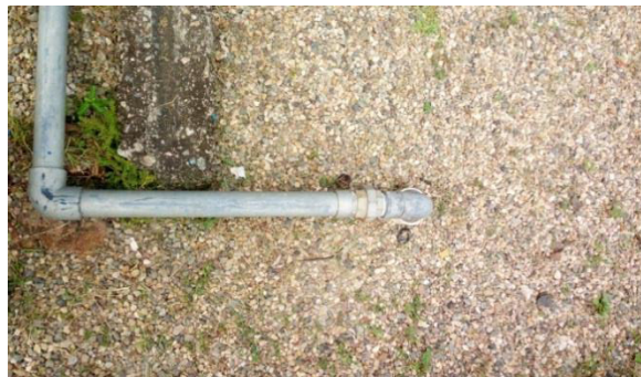
Imagen 1. Ingreso de agua, tubería de succión del pozo
