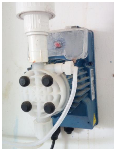
Imagen 11. Bomba dosificadora de cloro
