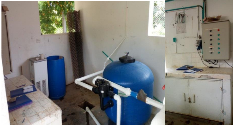
Imagen 16. Unidad de Operación de la PTAP
