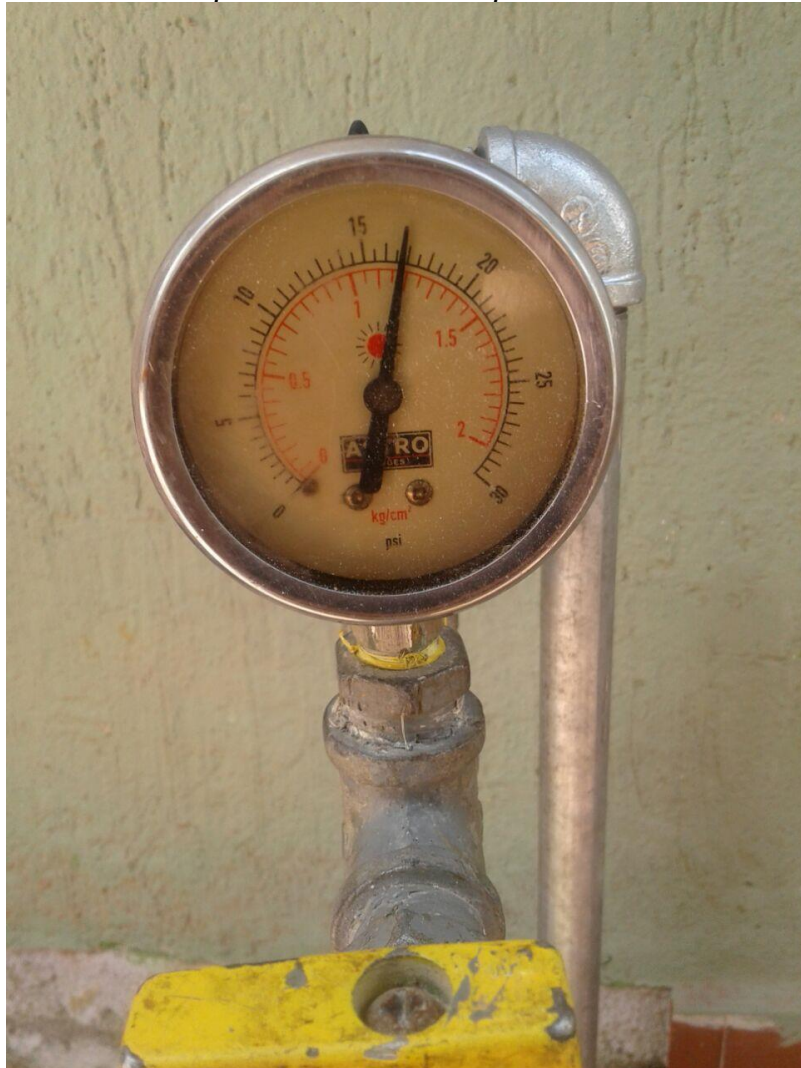
Ilustración 19. Manómetro para realización de prueba de hermeticidad
