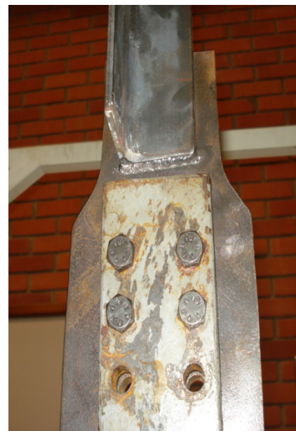
Foto N° 16. Ruptura de ct-3/32
