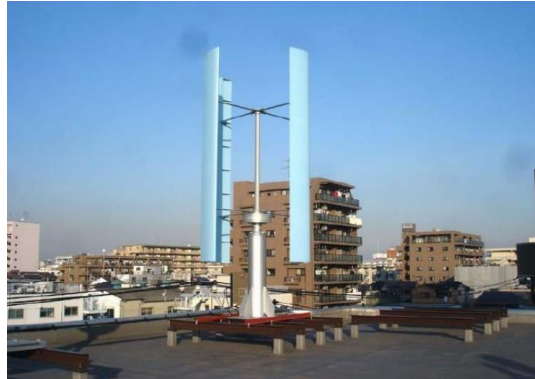
Figura 42. Aerogenerador Aeolos-V 10 kW en una azotea
