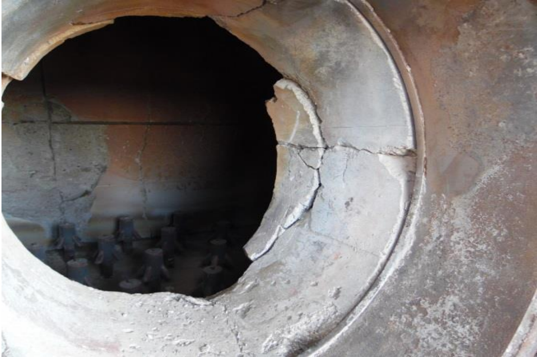
Figura 30. Manhole válvula J.
