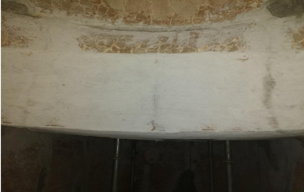
Figura 36. Pared interior válvula J reparada.
