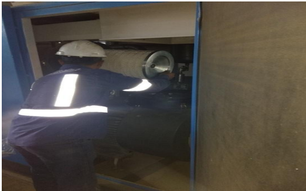
Figura 21. Cambio filtro de aire.
