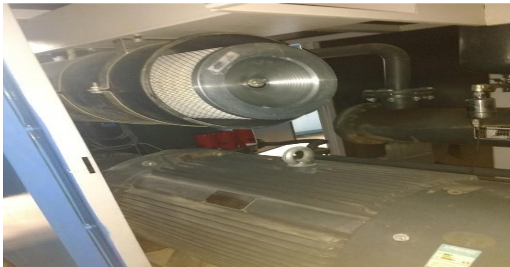
Figura 22. Instalación filtro de aire.
