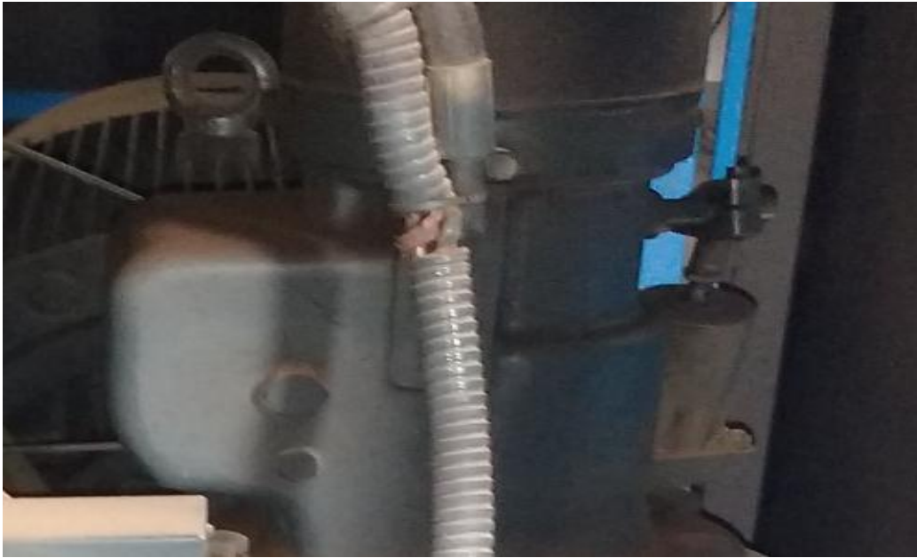
Figura 17. Deterioro de manguera compresor.
