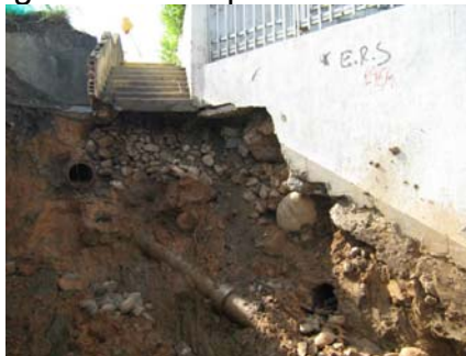
Figura 1. Daño puente cañaveral
