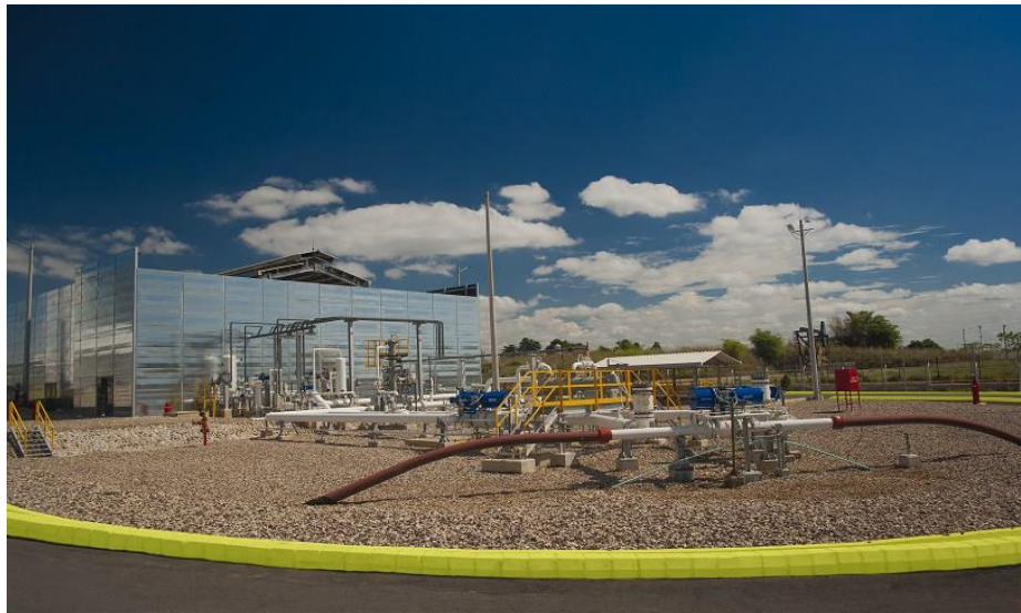
Ilustración 20. Estación compresora Los Pinos.
