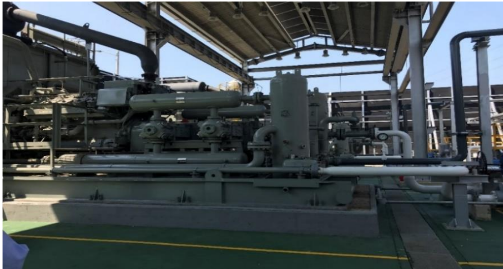
Ilustración 21. Sistema de compresores estación Los Pinos.
