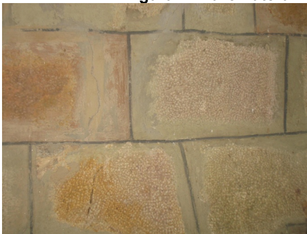
Figura 8. Fisuras Muro Lateral Derecho
