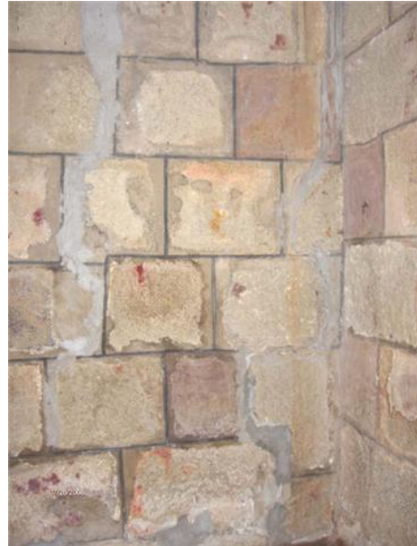
Figura 12. Fisuras Muro Lateral Derecho.
