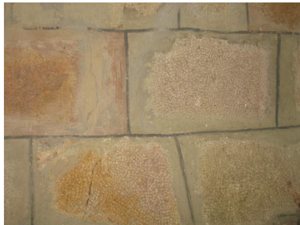
Figura 9. Fisuras Muro Lateral Derecho
