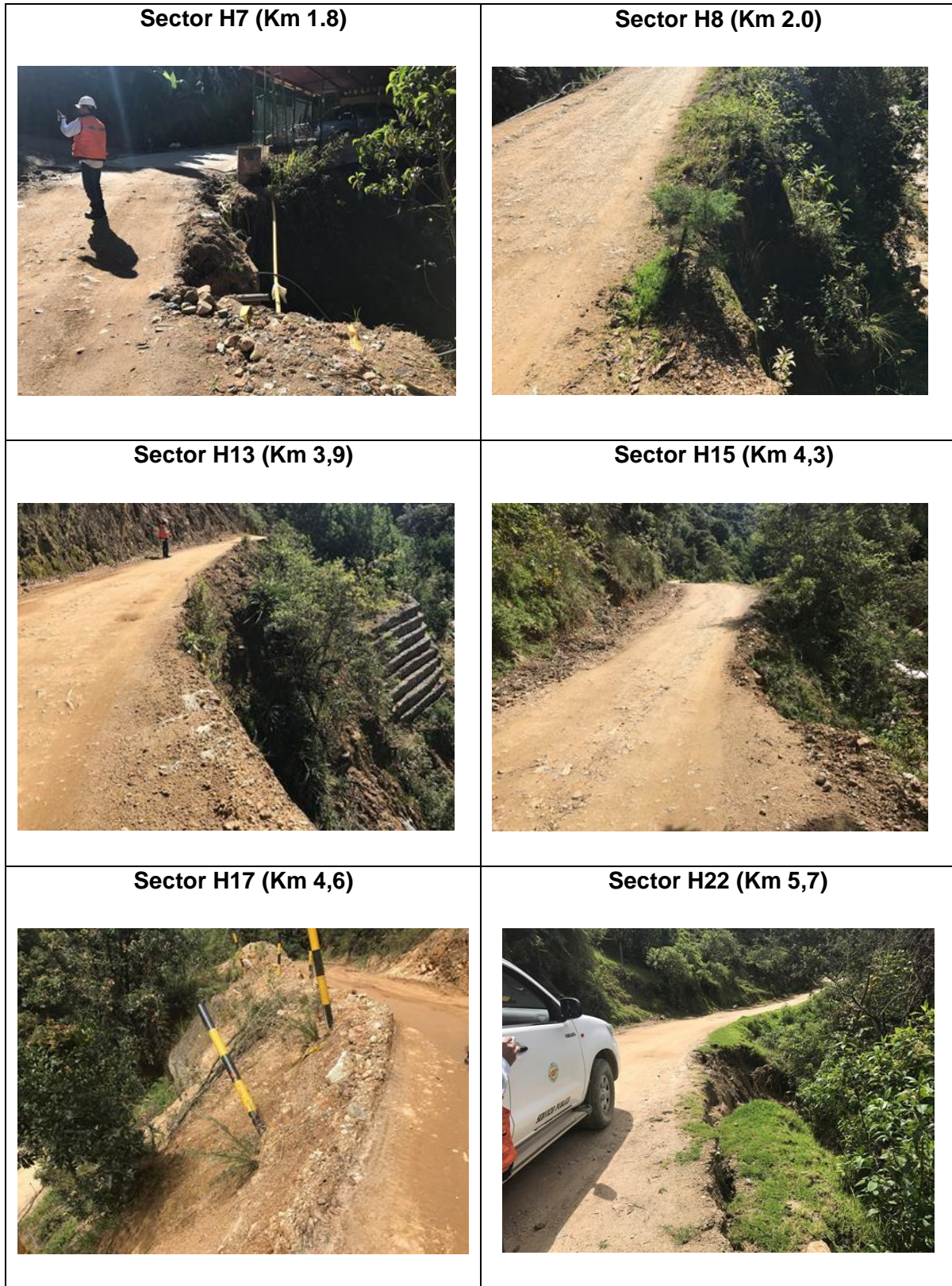
Ilustración 19: Sectores con peligro de caída a precipicio.
