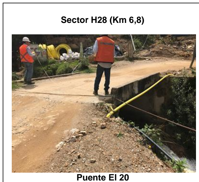
Ilustración 20: puente El 20 con falta de barandas o pasa manos
