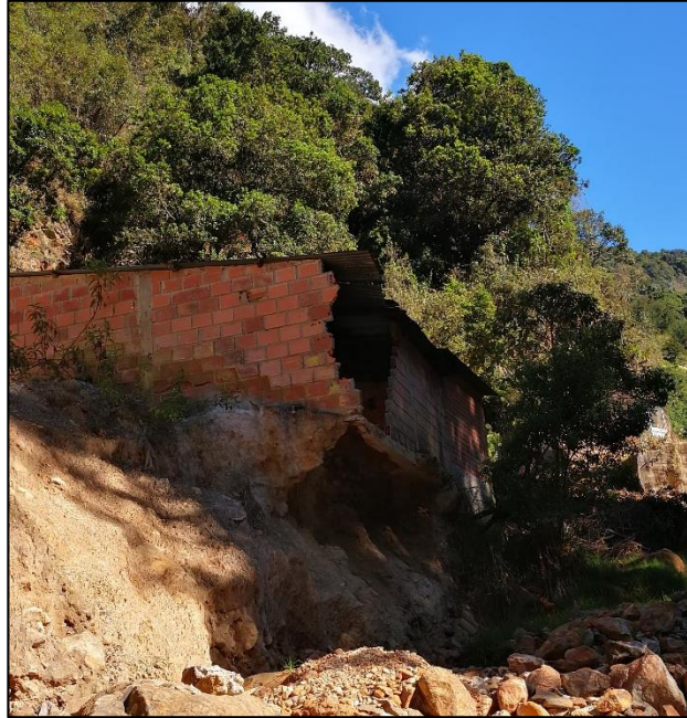
Fotografía 1: edificación con estructura afectada a causa de la avalancha en el año 2011
