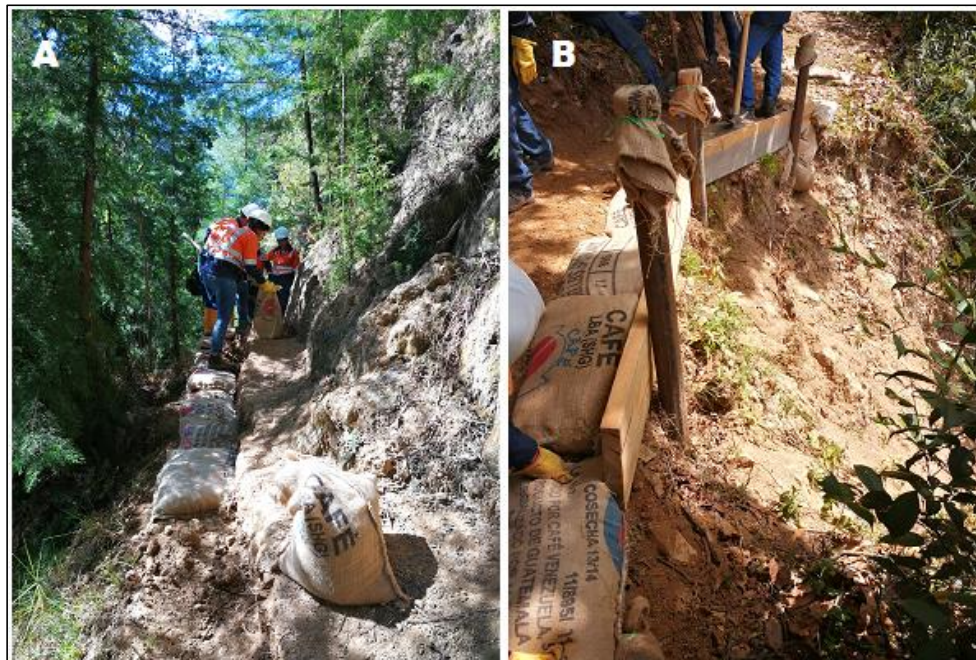
Fotografía 7: A) llenado de sacos con material de la zona y disposición al costado del pasillo como método de contención del suelo. B) trincho para aumentar ancho transitable y evitar procesos erosivos.
