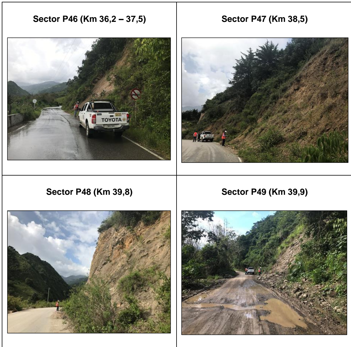
Ilustración 14: Sectores con riesgo de derrumbe por inestabilidad de taludes.
