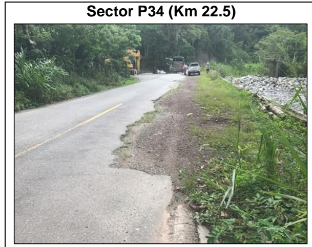
Ilustración 12: Estructura del pavimento en mal estado.
