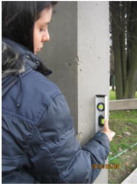
2018-06-08_Viernes / Control de calidad sobre columnas en concreto pre-mezclado de CEMEX, verificación de niveles, perpendicularidad, verticalidad
