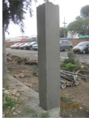
2018-06-08_Viernes / textura y lisura de la calidad final de la superficie de las columnas de concreto pre-mezclado de CEMEX, sección transversal de 30 cm x 30 cm.
