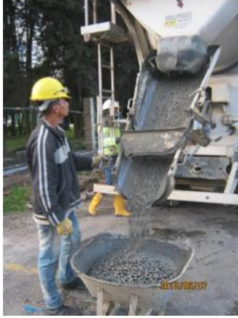
2018-06-07_Jueves / descarga de concreto pre-mezclado de CEMEX para fundido de columnas de sección transversal de 30 cm x 30 cm.
