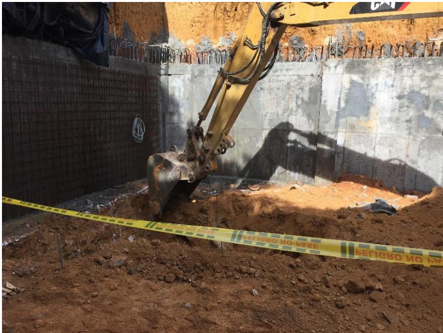
Imagen 21 Construcción muro de sótano para garantizar la protección del personal y de las estructuras circunvecinas
