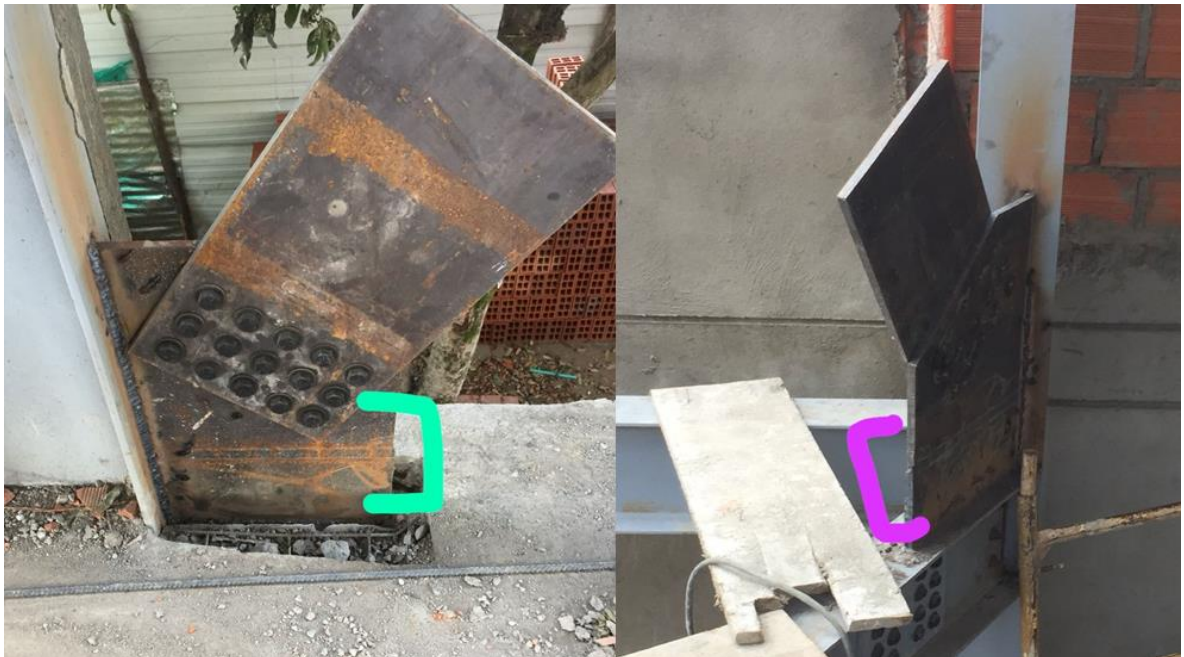
Imagen 10 Platinas de conexión soldadas
