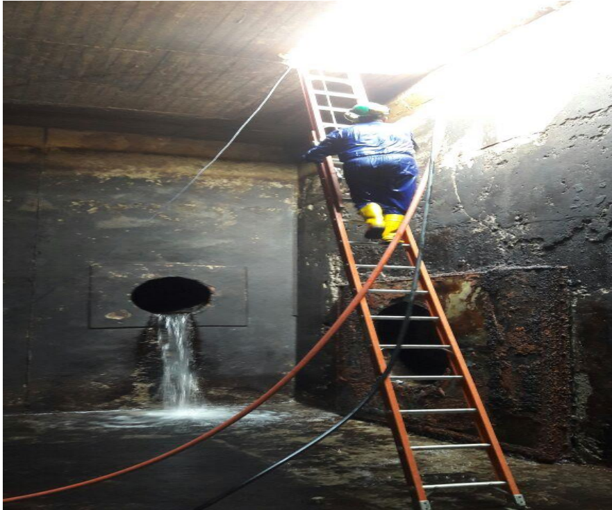
Figura 25. Ingreso de personal al tanque.
