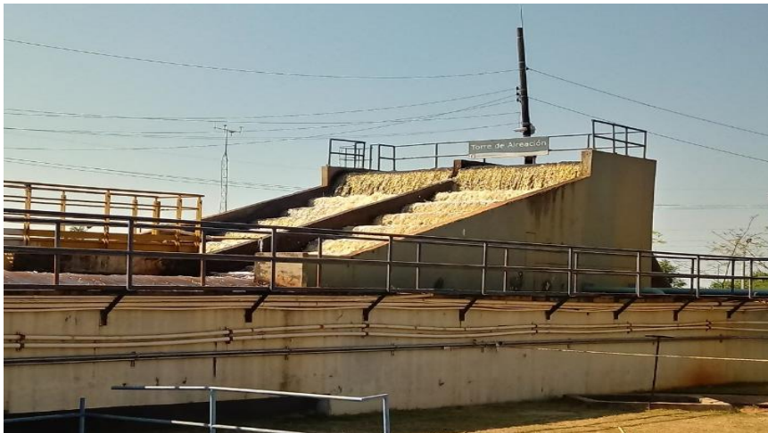
Figura 27. Torres de aireación.
