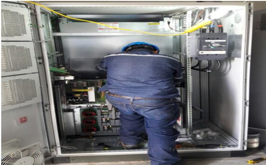
Figura 22. Mantenimiento de filtros activos.
