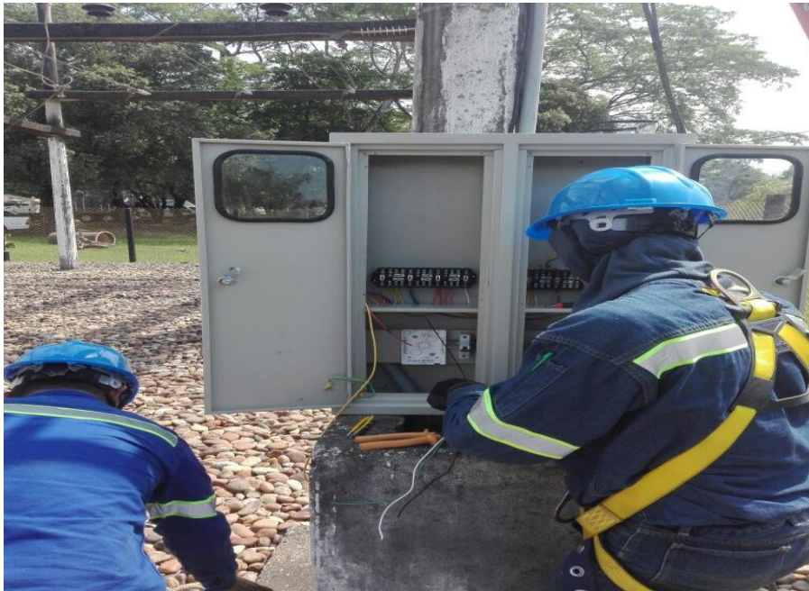
Figura 20. Conexión de tablero de medición de energía. Fuente: Tomada directamente en la Empresa Aguas de Barrancabermeja S.A.E.S.P.
