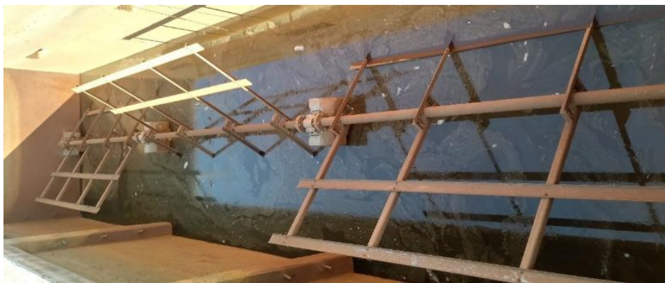
Figura 29. Paletas giratorias instaladas sobre ejes horizontales de los floculadores.
