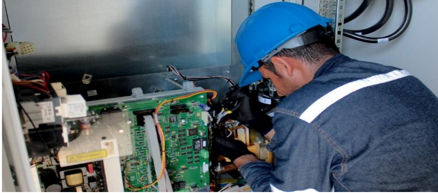
Figura 21. Revisión estado de tarjetas electrónicas de los filtros activos.
