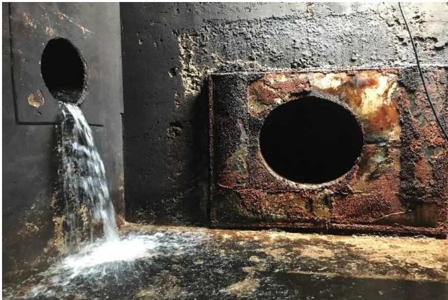
Figura 24. Drenaje de tanques. Fuente: Tomada directamente en la Empresa Aguas de Barrancabermeja S.A.E.S.P.
