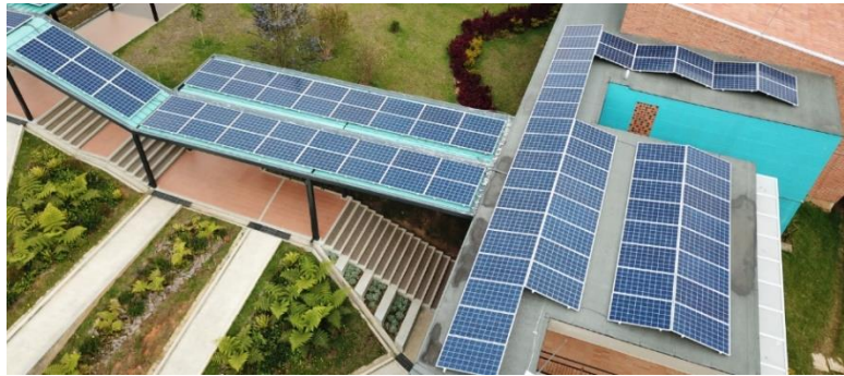
Figura 13. Paneles en la circulación.. Imagen tomada de: Erco, energía. .
