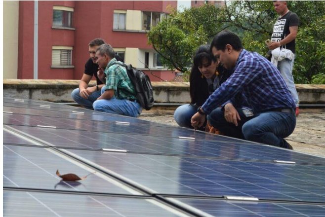
Figura 16. Sistema solar fotovoltaico Bloque 10. Imagen tomada de: Revista UPB.
