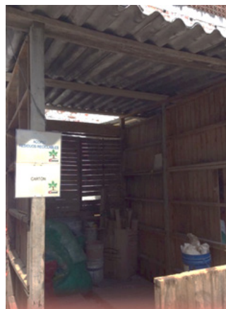
Ilustración 50. Almacenamiento residuos reciclables
