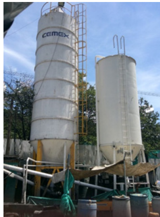
Ilustración 45. Planta de concreto
