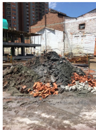
Ilustración 44. Disposición de escombros
