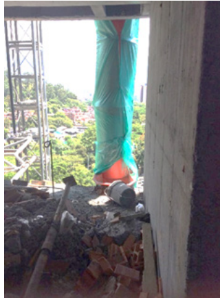
Ilustración 40. Ducto transporte vertical
