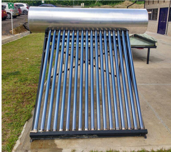
Figura 29. Termotanque instalado provisionalmente.
