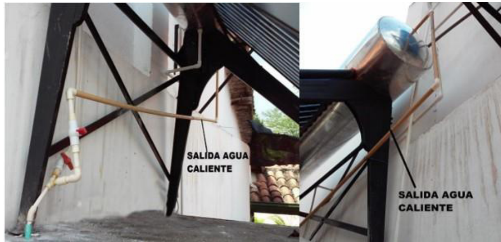
Figura 34. Instalación agua caliente.
