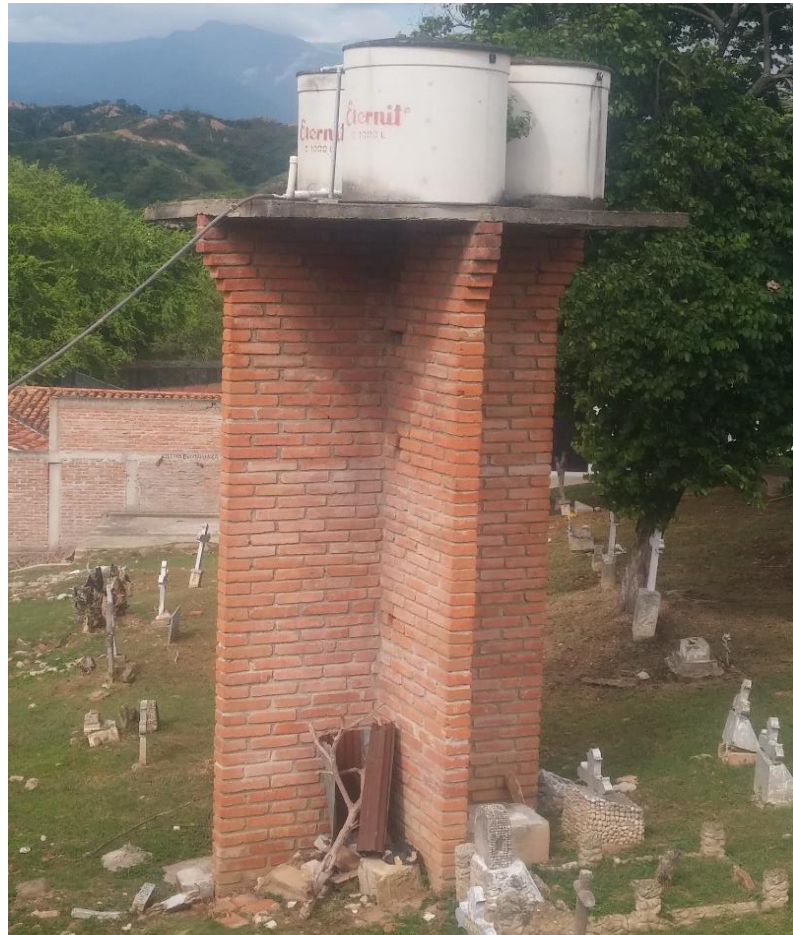
Figura 31. Torre de tanques aéreos del asilo el Señor de los Milagros.
