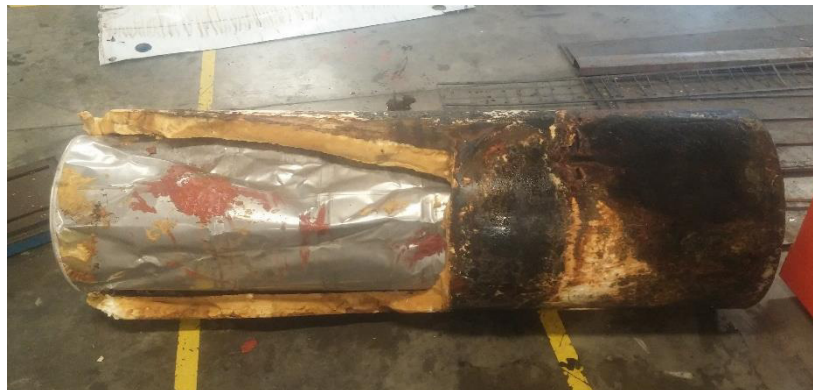
Figura 17. Estado del termo tanque.
