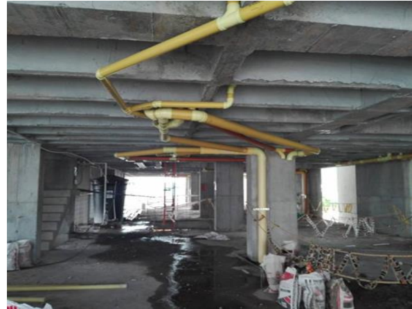
Figura 42. Tubería Sanitaria Parquaderos
