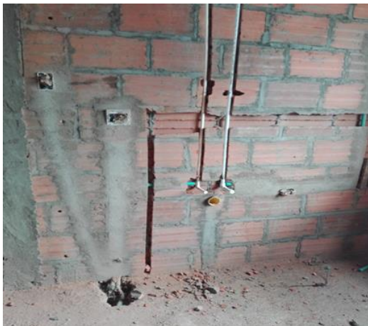
Figura 39. Tubería hidráulica cocina
