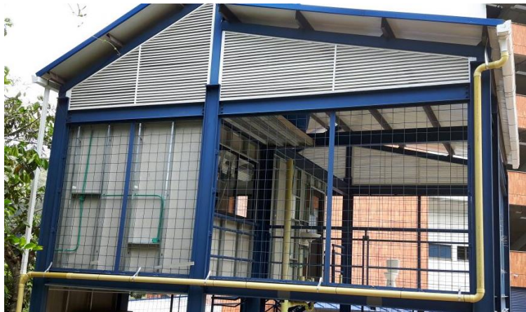
Figura 32. Tramo izquierdo tubería PVC
