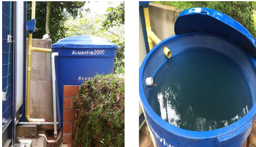
Figura 37. Tanque de almacenamiento
