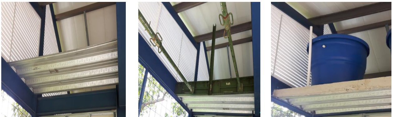
Figura 42. Placa tanque aéreo
