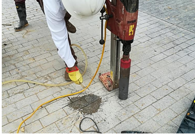
Figura 45. Núcleo una fisura del pavimento en concreto hidráulico. Fuente: Autor.
