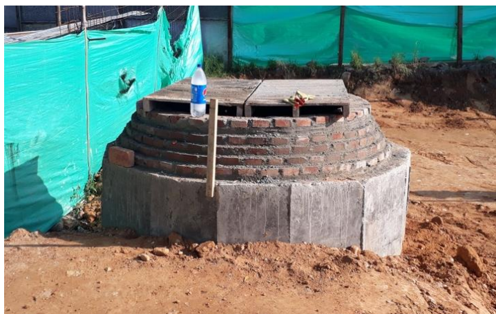
Figura 8. Relleno de material e instalación de la reducción del pozo. Fuente: Autor.
