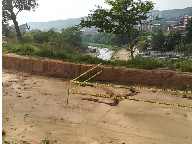
Figura 44. Grietas en el talud. Fuente: Autor.
