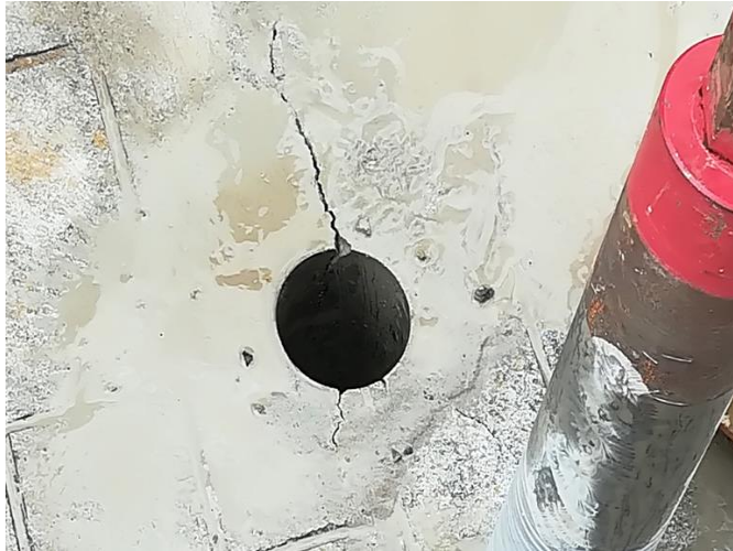
Figura 46. Fisura y núcleo. Fuente: Autor.
