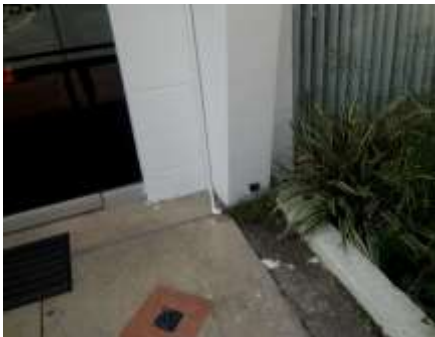
FIGURA 14. Elemento arquitectónico que incumple paramento
