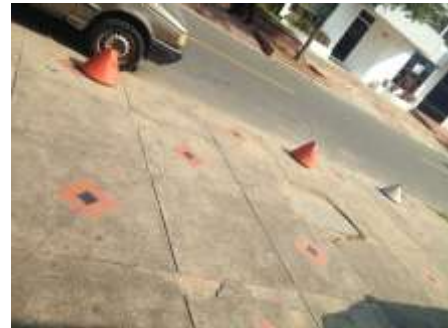
FIGURA 16. Incumplimiento franja ambiental y losetas
