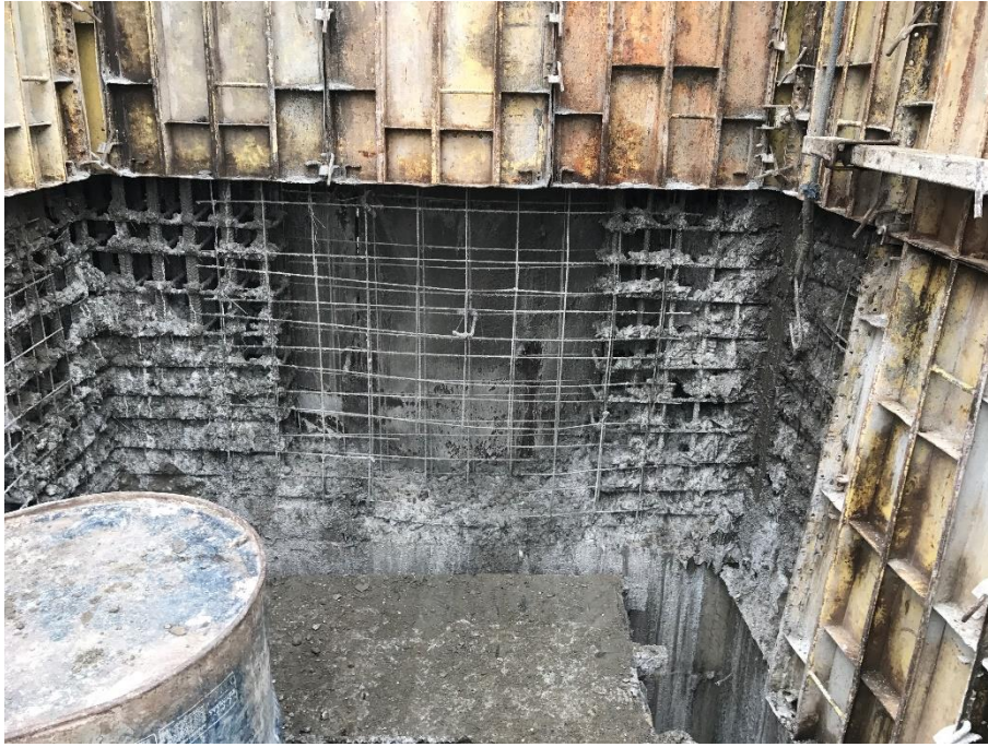
Figura 29: Fallo de ascensor columnas 8-9 el 09/09/2018
