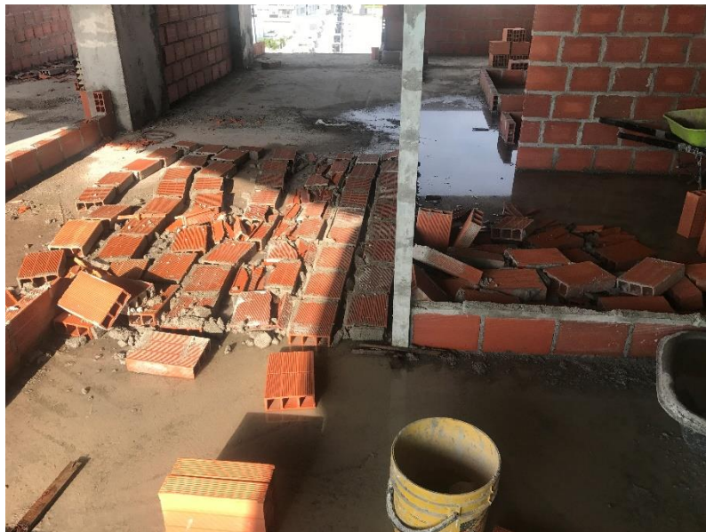
Figura 10: Evento caída de muro por lluvia.
