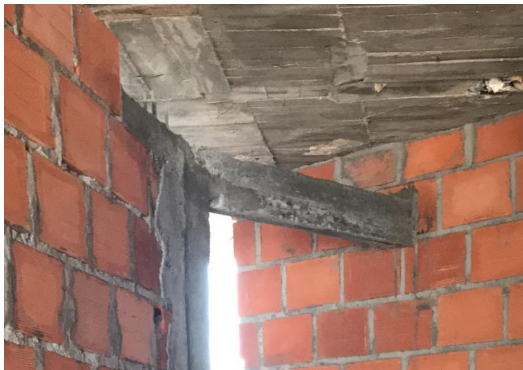
Figura 14: Dintel puerta principal apartamento tipo 1 piso 2
