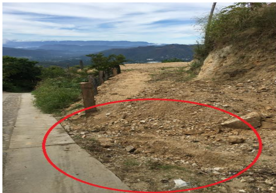
Ilustración 17: Daños en los canales de la vereda Meseta Grande
