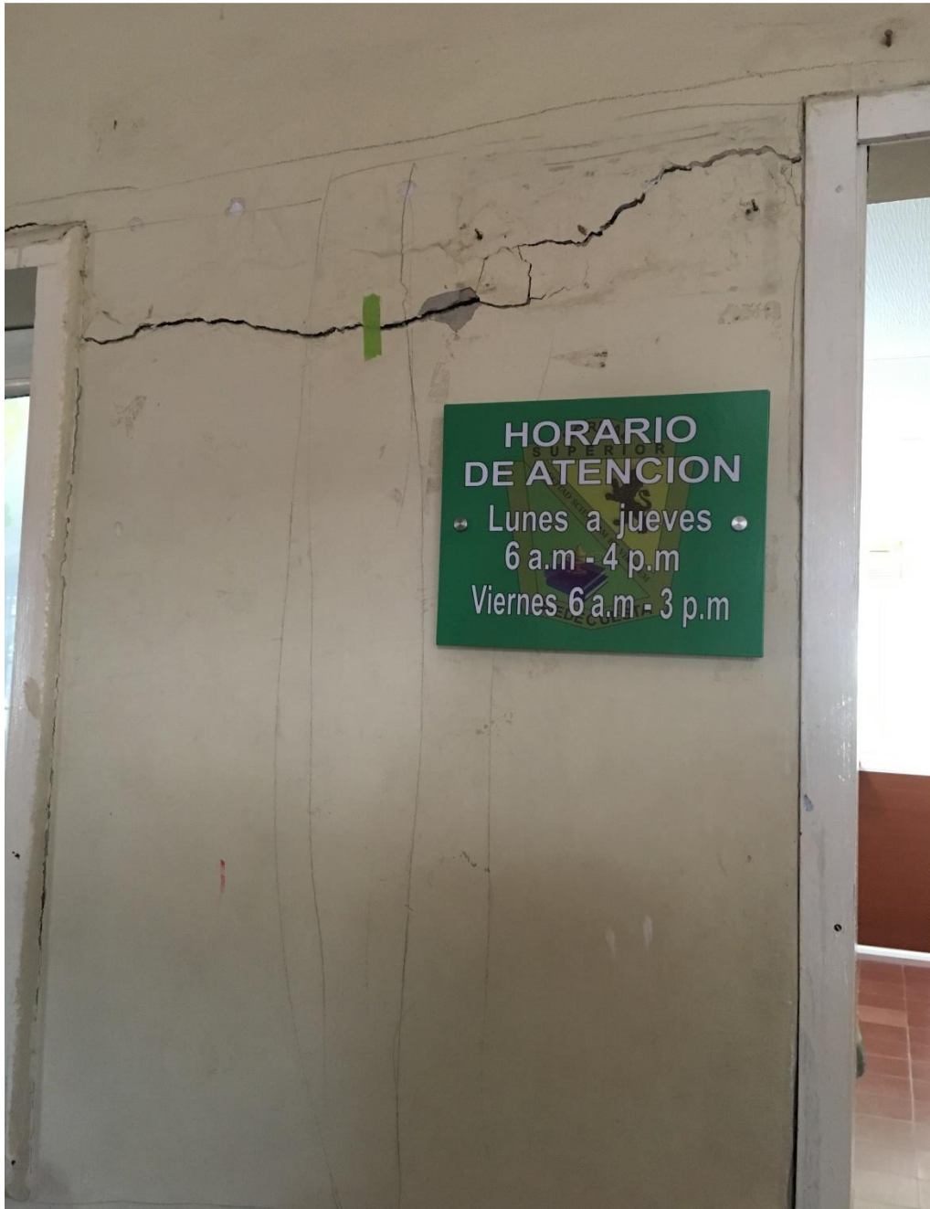
Ilustración 20: Grieta en la parte externa de la oficina (generada por falla de columna corta) en un muro de la Escuela Normal Superior de Piedecuesta.
