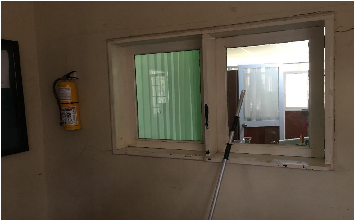
Ilustración 18: Ventana que genera falla de columna corta en un muro de la Escuela Normal Superior de Piedecuesta.
