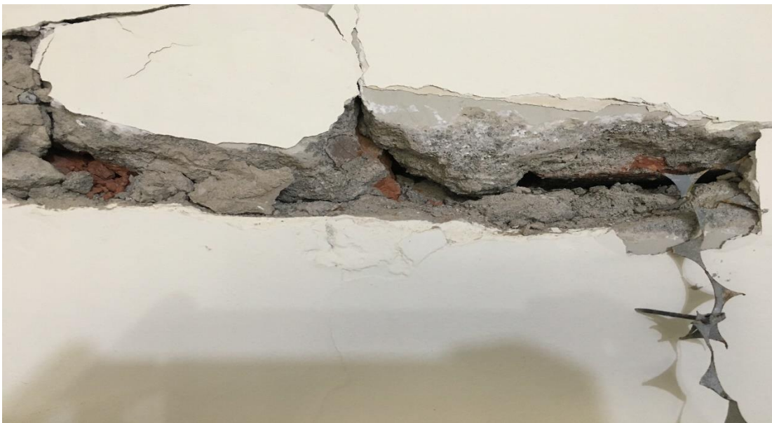
Ilustración 19: Grieta generada por falla de columna corta en un muro de la Escuela Normal Superior de Piedecuesta.
