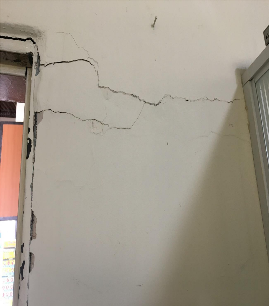
Ilustración 21: Grieta en la parte interna de la oficina (generada por falla de columna corta) en un muro de la Escuela Normal Superior de Piedecuesta.
