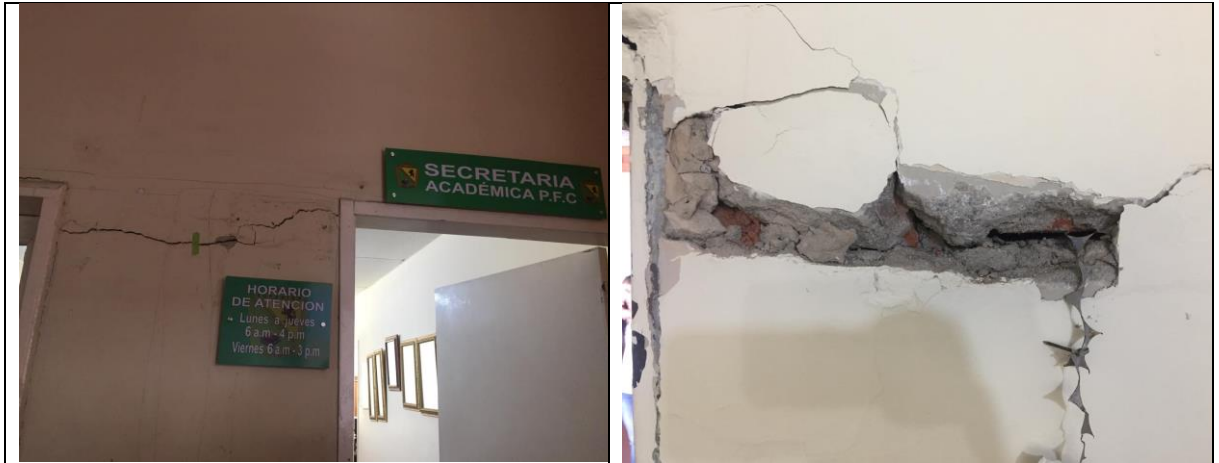
Imagen 15. Mal estado muro secretaria académica, Escuela Normal Superior de Piedecuesta, Autor.
