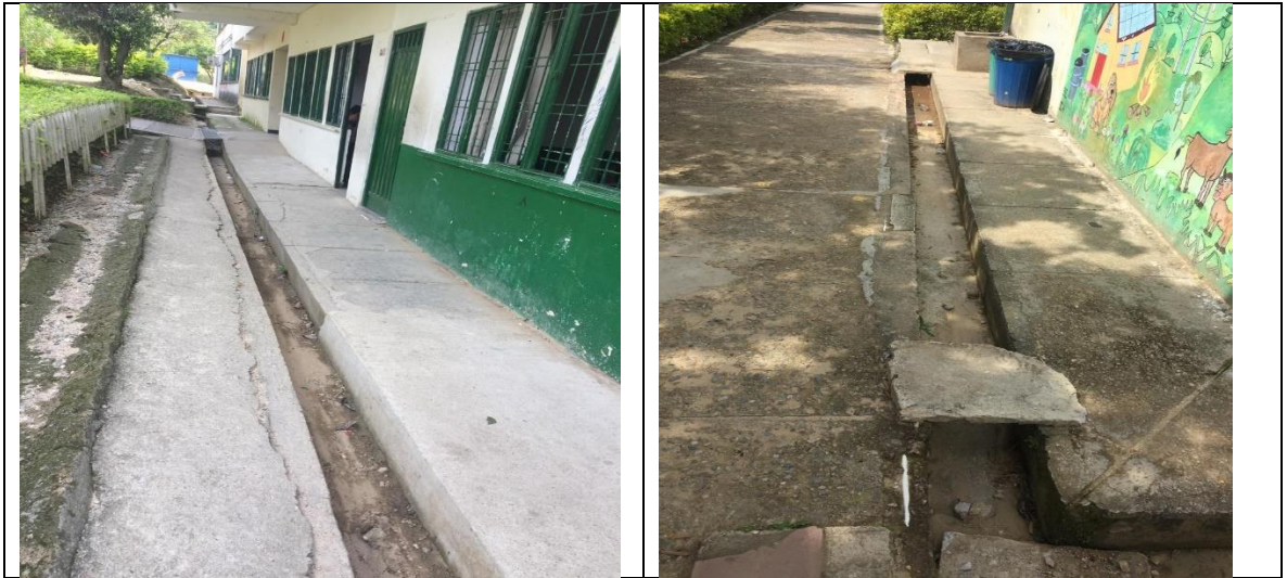
Imagen 17. Estado de las canaletas, Escuela Normal Superior de Piedecuesta, Autor.
