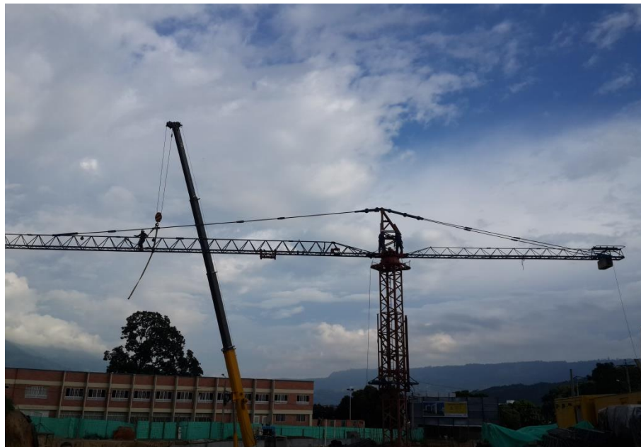
Figura 12: Imagen equipo principal TORRE GRUA POTAIN NCZ 428TG03
