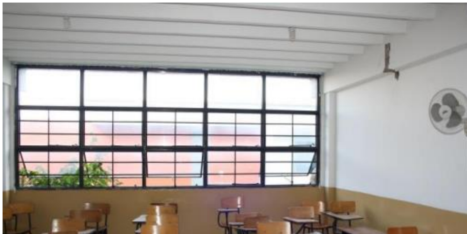
Figura 5. Evidencia fotográfica sistema estructural con ausencia de vigas entre pórticos, tomado del Estudio de vulnerabilidad sísmica, LSJ Ingeniería, consultoría y construcción.
