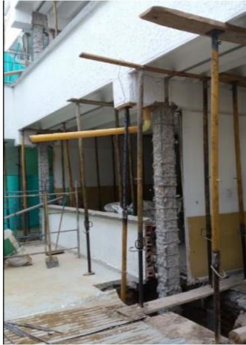
Figura 18. Escarcilamiento de columnas D-3 y D-2 y excavación a profundidad de sus cimientos.
