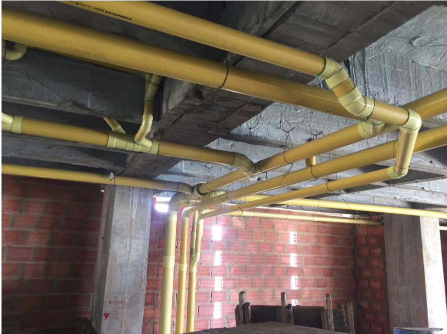
Figura 16, Tubería Sanitaria descolgada.
