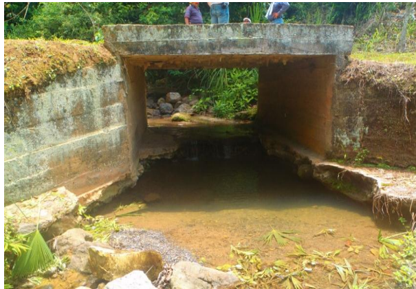
Foto 36. Estado inicial del puenton (Santa Inés)
