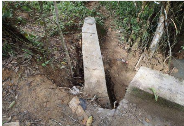
Foto.32 Aleton en concreto 3500 psi
