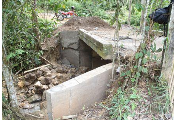
Foto 34. Aleton en concreto 3500 psi
