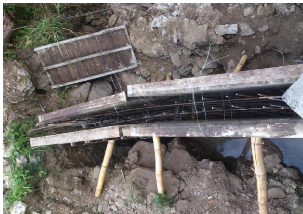
Foto.44 Detalle de refuerzo de aleton de box couvert
