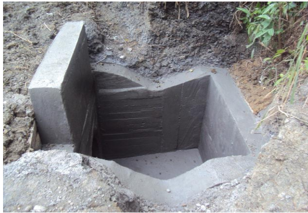
Foto.79 Cabeza de entrada de Alcantarilla La Unión
