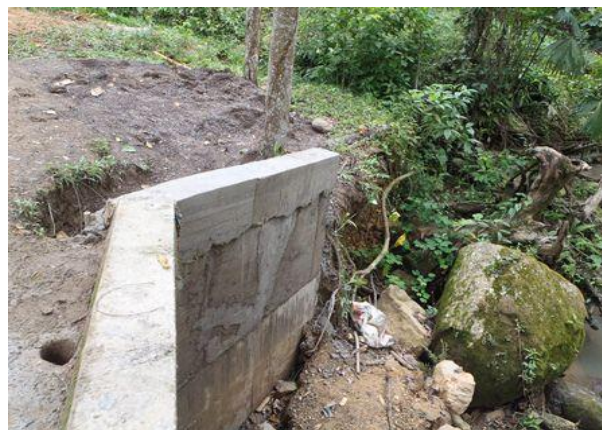
Foto 33. Aleton en concreto 3500 psi (Palo Tigre)
