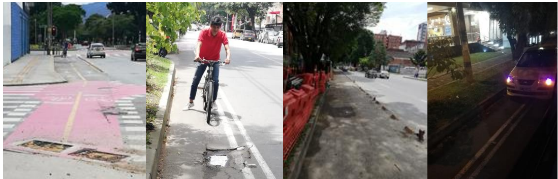
Imagen 26. Alcantarillas en las ciclorrutas y baches.
