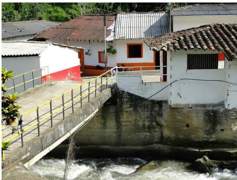
Foto 17. Antiguo puente de concreto derribado por la avenida torrencial.
