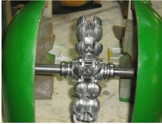
Figura 47. Vista Interior de la Turbina Pelton
