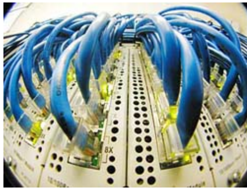
Paneles de parcheo (patch panel)
