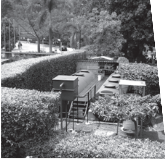
Planta de Tratamiento de Aguas Residuales de la UPB
