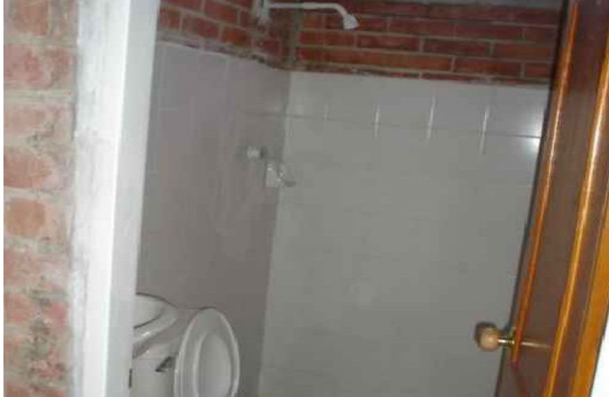
Figura 40. Detalle típico del baño construido en cada una de las viviendas, con enchapes y aparatos sanitarios de línea económica.
