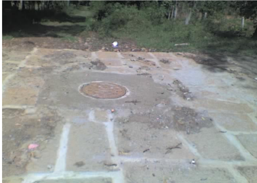
Figura 20. Luego de levantar el pozo de aguas negras Calle 5 entre carreras 1 y 2.
