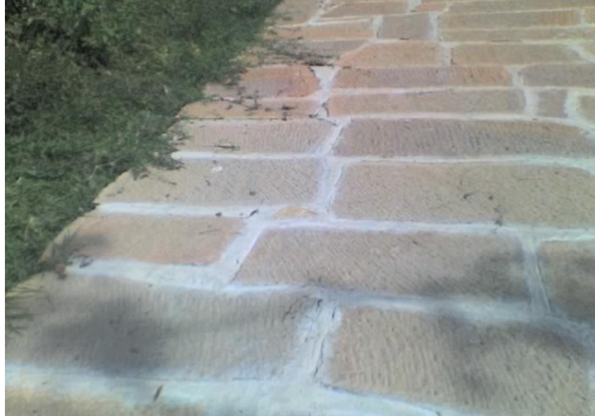
Figura 26. Estado de la vía luego de terminar los trabajos de la Calle 4 entre carreras 3 y 4.
