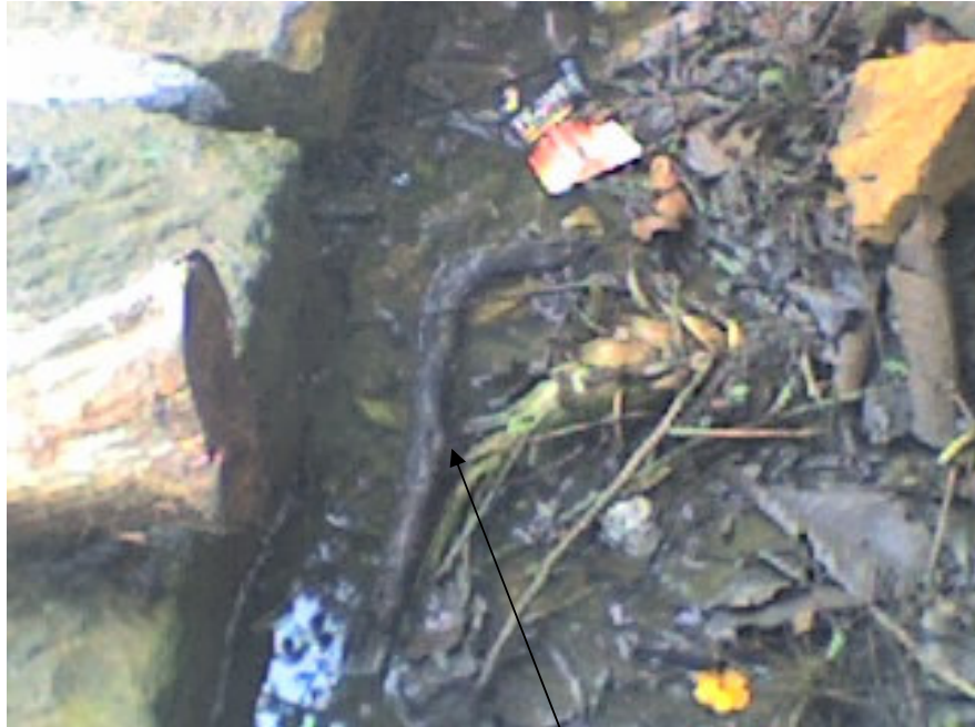
Figura 8. Zoom filtraciones del terreno de Carrera 1 entre calles 4 y 5
