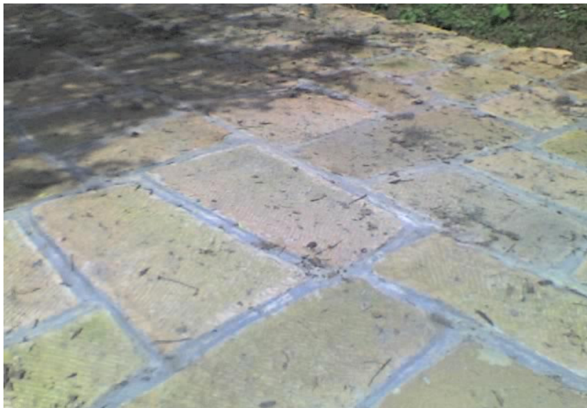
Figura 27. Estado de la vía luego de terminar los trabajos de la Calle 4 entre carreras 3 y 4.
