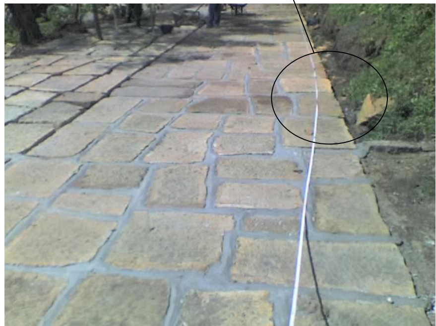
Figura 9. Filtraciones del terreno de Carrera 1 entre calles 4 y 5
