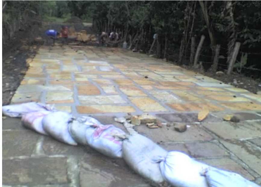
Figura 16. Corte de agua en la Calle 5 entre carreras 1 y 2.
