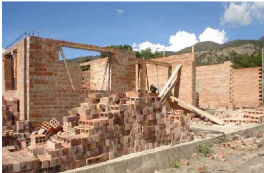
Figura 31. Se aprecian 2 viviendas en proceso de levante de la mampostería parcialmente reforzada.
