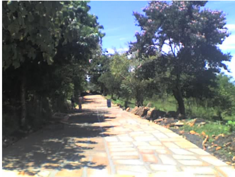
Figura 10. Estado de la vía luego de terminadas las labores de la Carrera 1 entre calles 4 y 5
