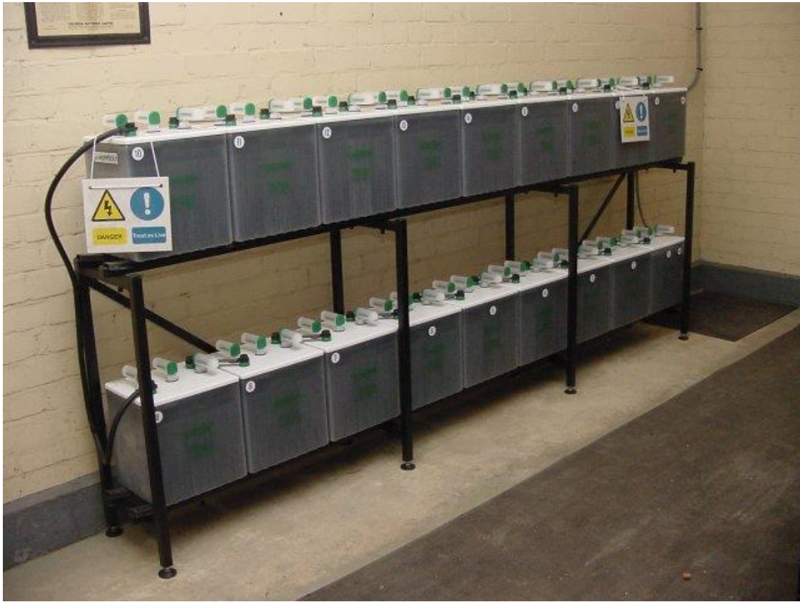
Figura 10. Banco de baterías. Fuente [26]
