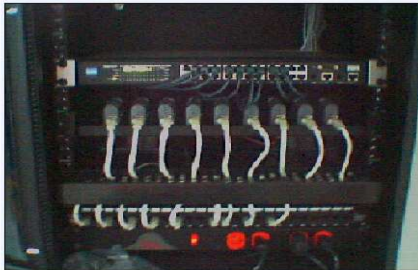
Fig. 39 Rack e comunicaciones U.C.S.N.
