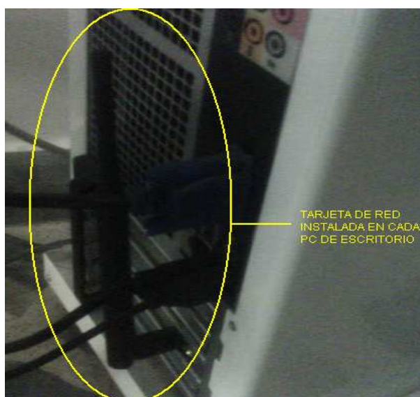
Fig. 48 Tarjetas de Red instaladas.
