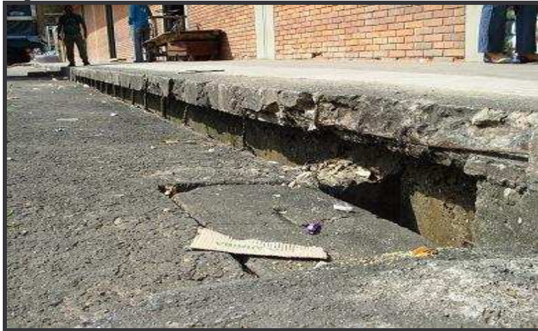
Figura 19. Sumidero en mal estado.
