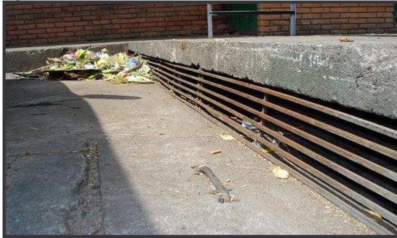
Figura 20. Sumidero en buen estado.
