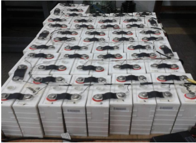
Figura 16. Banco de baterías utilizado para alimentar el VE (Cuartas, 2014)
