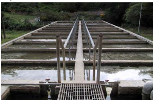
Figura 10: Planta de tratamiento.
