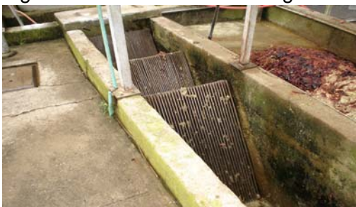
Figura 7: Cribado de PTAR Frigorífico
