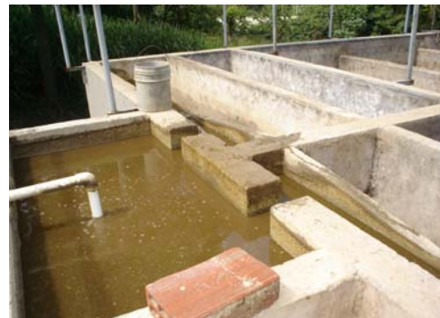
Figura 9: Adición de cloro a tanque
