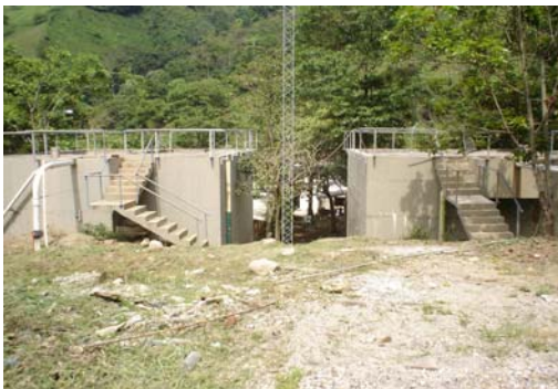
Figura 8: Tanques de igualación.
