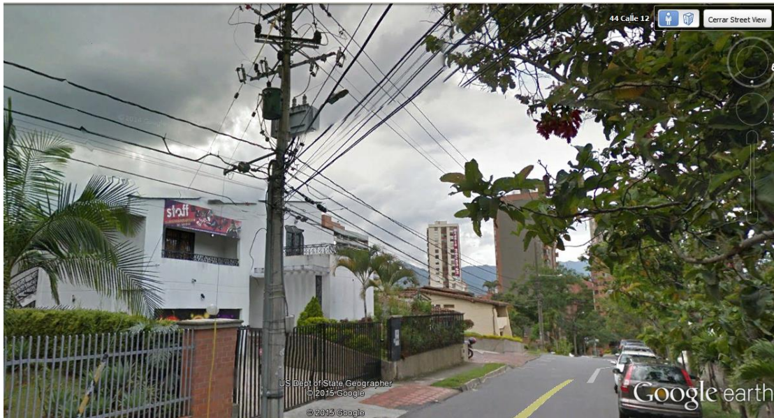
Figura. 24. Ubicación real de un transformador en una localización específica.
