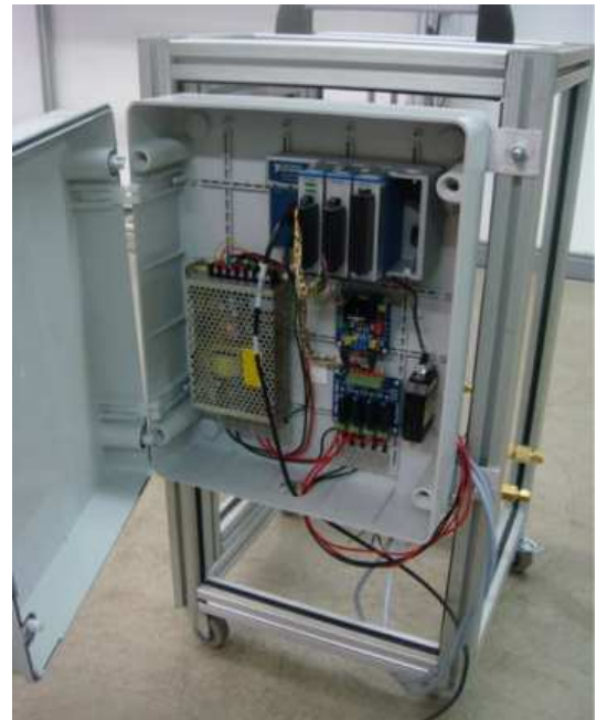
Figura 10. Tablero de conexiones Banco de Carga de Refrigerante
