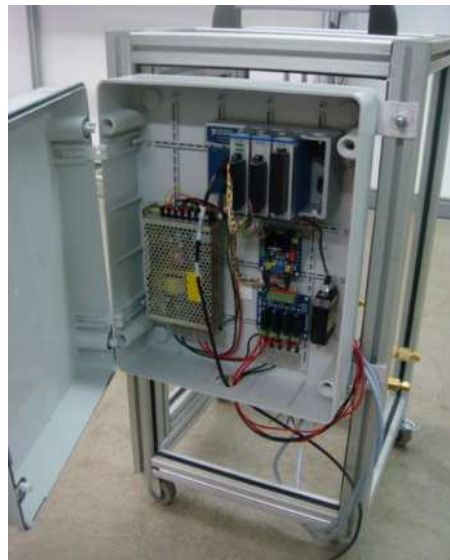
Figura 48. Tablero de conexiones Banco de Carga de Refrigerante
