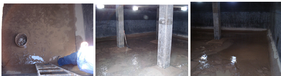
Figuras 22, 23 y 24. Tanque de regulación, Sistema de agua potable La Luz, Río Grande.
