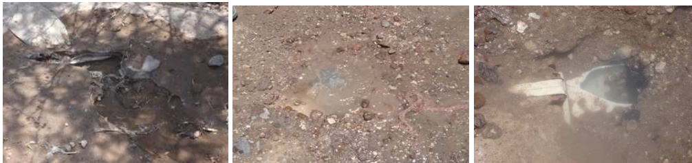
Figuras 31, 32 y 33. Fugas en la Localidad La Florida.
