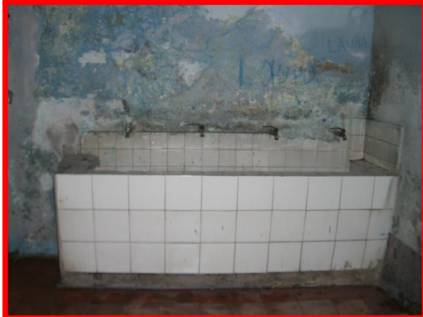
Imagen 14. Lavamanos Fuente: Propia.
