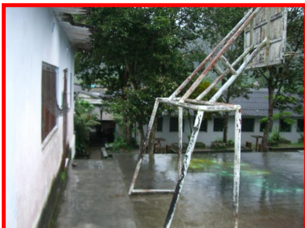
Imagen 16. Patio trasero evidencia deterioro Fuente: Propia.
