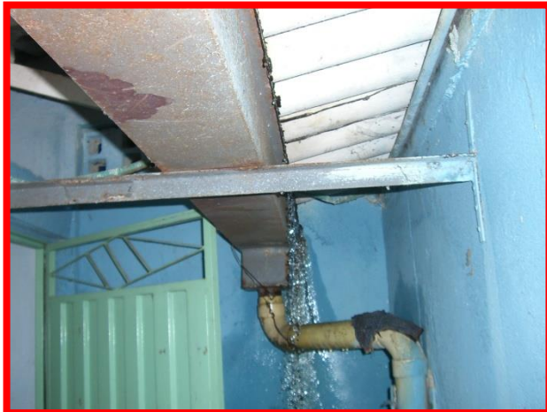
Imagen 12. Taponamiento de los bajantes Fuente: Propia.
