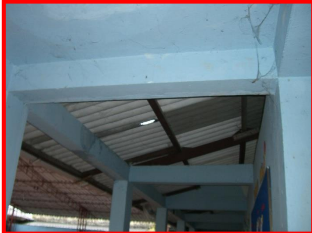
Imagen 11. Evidencia de goteras en los techos Fuente: Propia.
