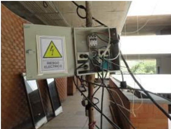
v. Caja de fusibles
