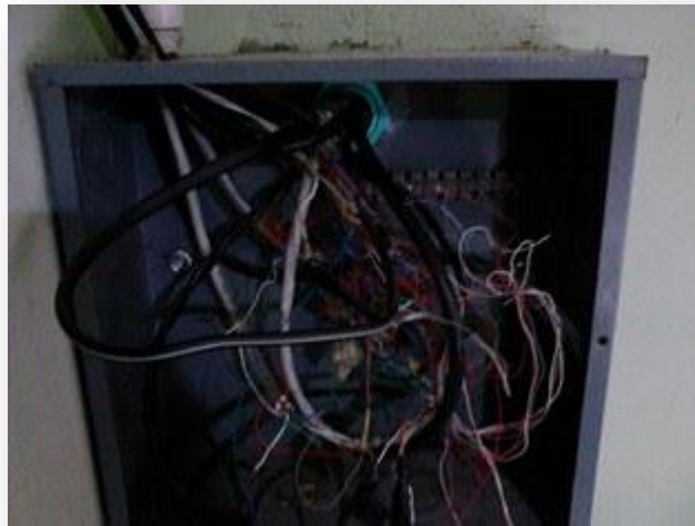
Imagen 7. Cable del ISP, Clínica San José. Fuente: El Autor
