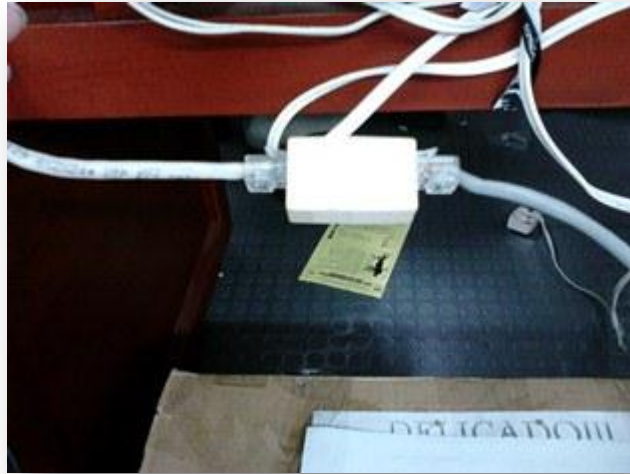
Imagen 5. Uniones de Cable, , Clínica San José. Fuente: El Autor
