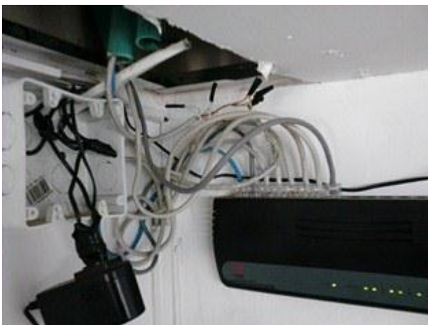
Imagen 4. Switch (2), Clínica San José. Fuente: El Autor
