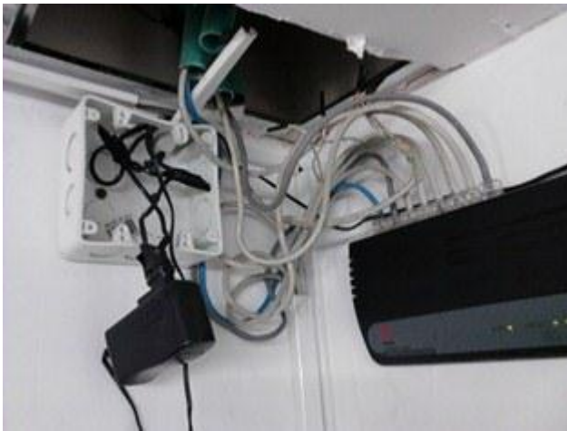
Imagen 3. Switch, Clínica San José. Fuente: El Autor
