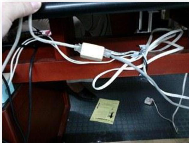
Imagen 6. Uniones de Cable (2), Clínica San José. Fuente: El Autor
