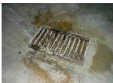
Fotografía 12: Área de Trasvase de Sustancias Químicas de Servicios Generales ICF
