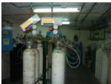
Fotografía 11: Área de Almacenamiento de Gases Medicinales
