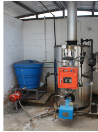
Fotografía 6: Caldera de Gas
