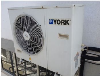
Fotografía 5: Aire Acondicionado 24000 BTU
