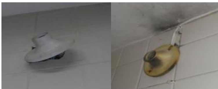
Fotografía 49. Plafones en mal estado
