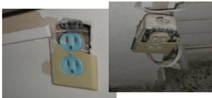
Fotografía 48. Enchufe en mal estado
