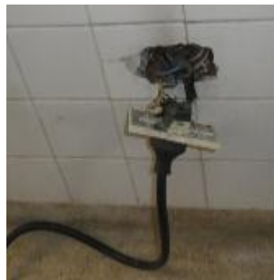
Fotografía 18. Enchufe en mal estado
