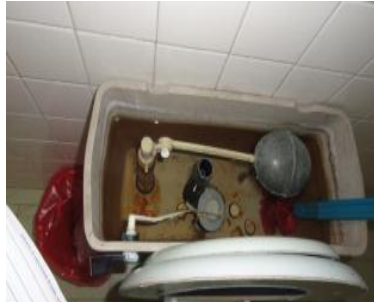
Fotografía 78. Tanque del inodoro sin tapa
