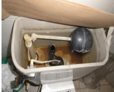
Fotografía 16. Tanque del agua del inodoro sin tapa
