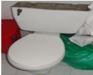
Fotografía 47. Sanitario en mal estado
