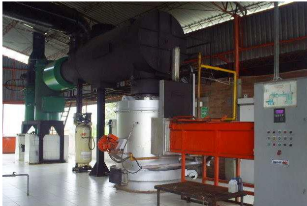
Imagen 5. 6 Horno INCOL PY80. Fuente: ASEO URBANO S.A. E.S.P.
