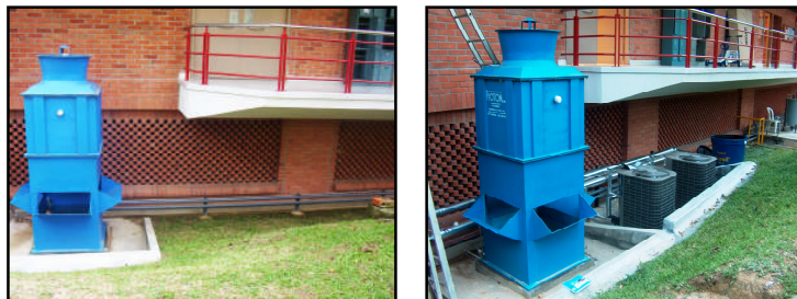
Figura 1. Espacio ubicación de unidades enfriadoras
