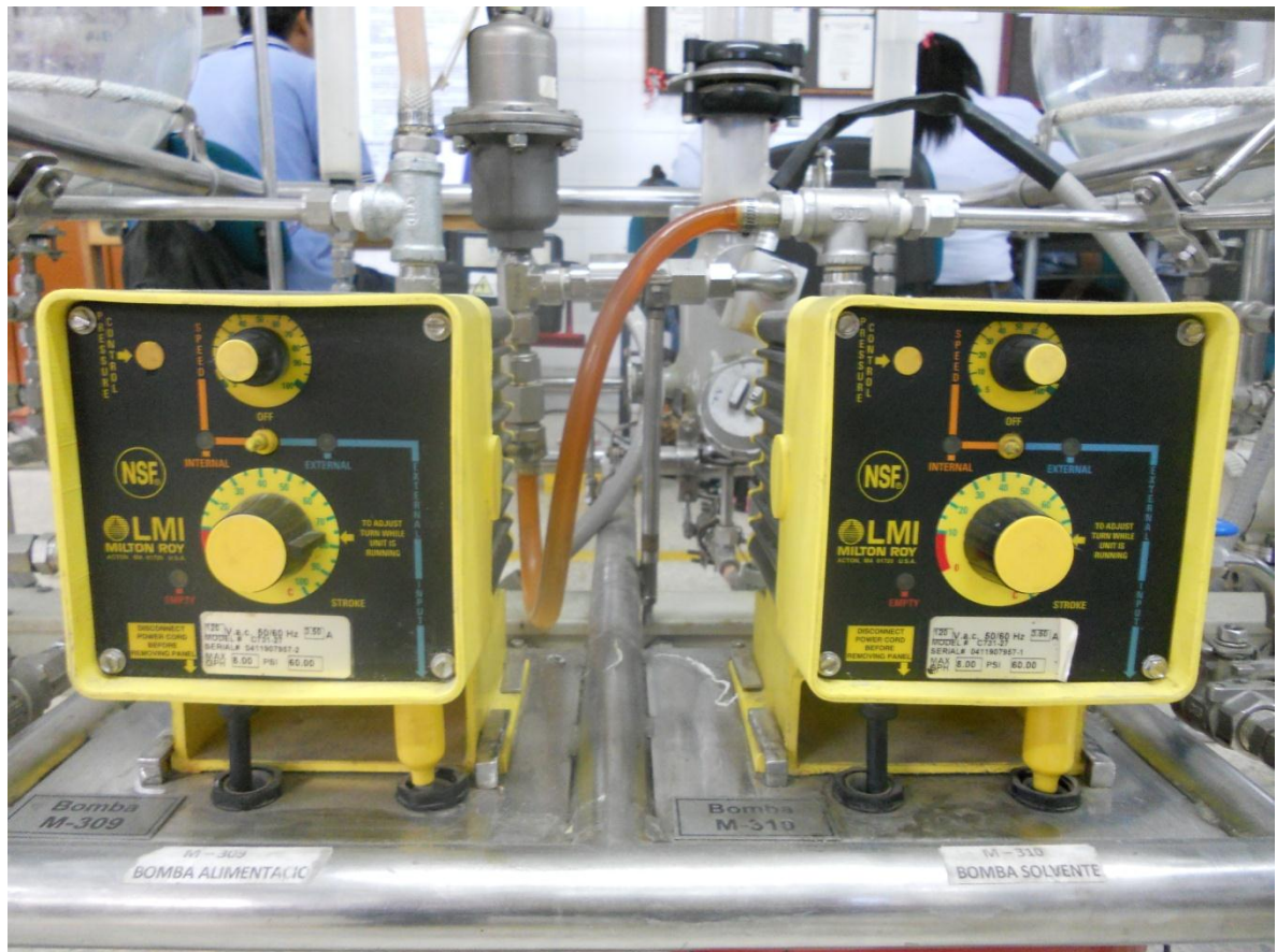
Figura 19. Bombas Dosificadoras Marca Milton Roy. [14]
